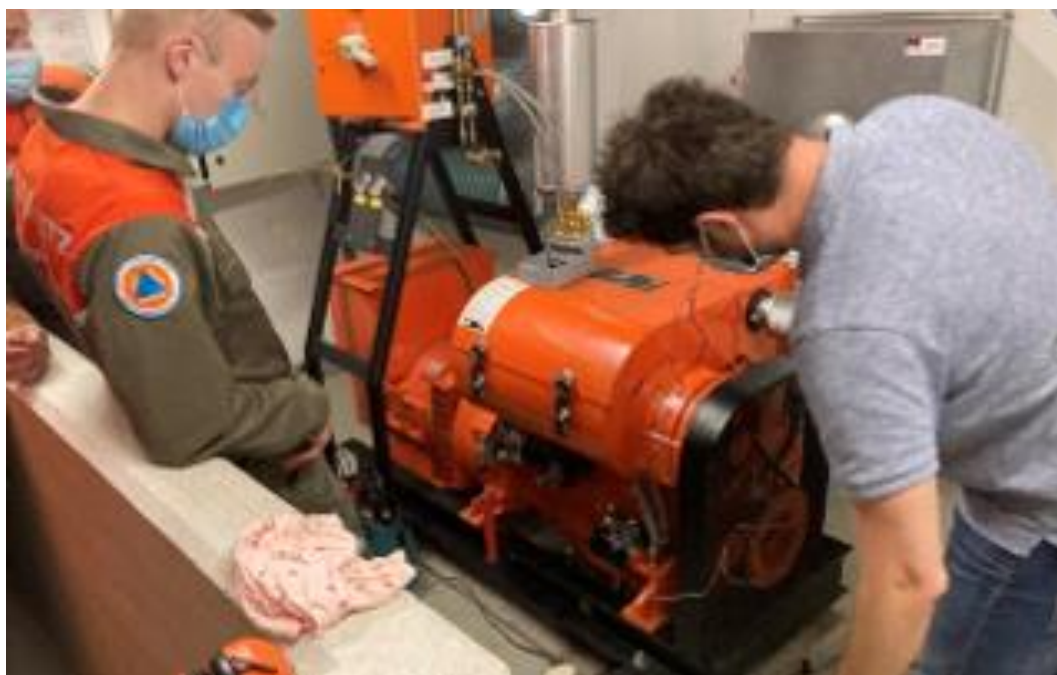
Notstromanlage KP Wangen a/A
